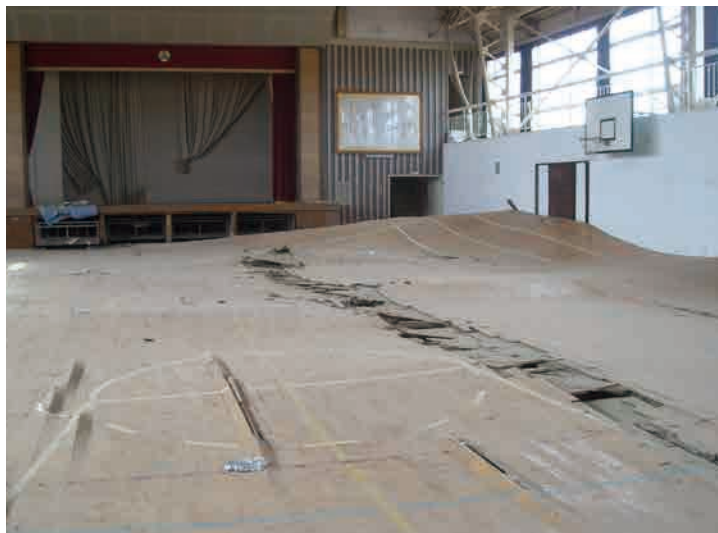
宮城県東松島市 浜市小学校体育館（被災後）
