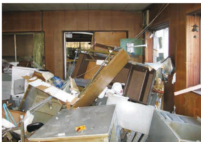
撮影：2011.3.13 岩手県釜石市 被災した元事務所 (石村 真一さん提供)
