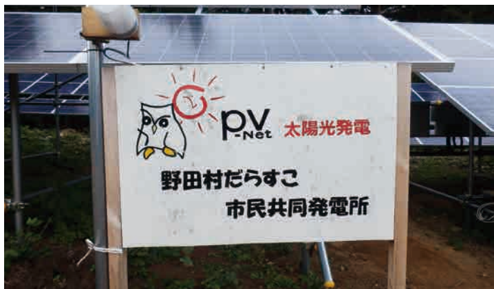
野田村だらすこ市民共同発電所
