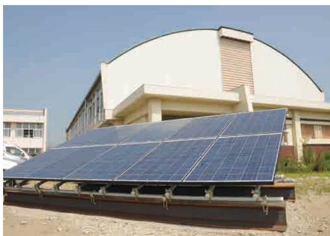
撮影：2012.7.30 東松島市旧浜市小学校に設置したソーラーパネル
