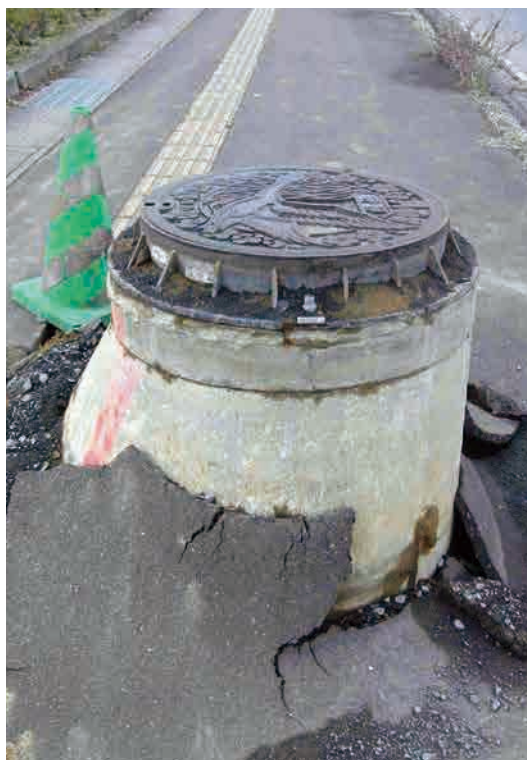
宮城県栗原市 飛び出したマンホール
